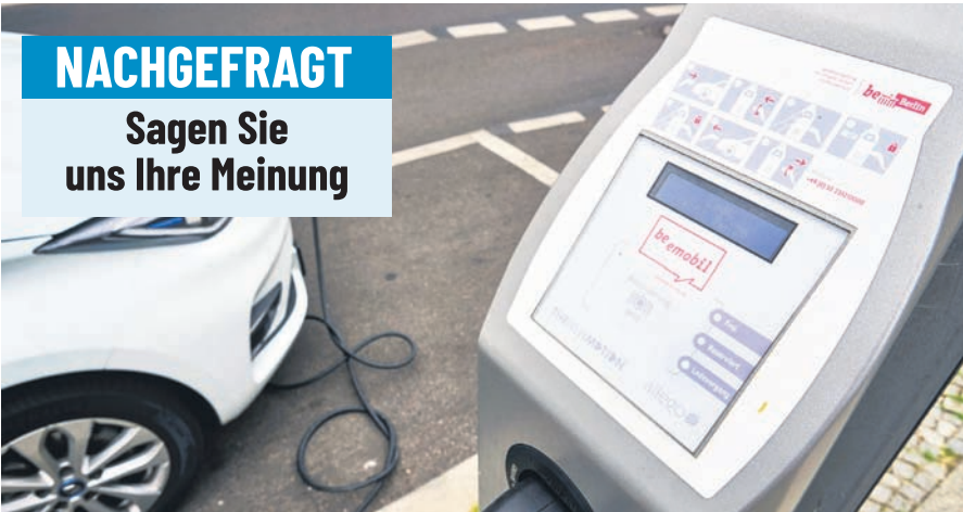
Eine Ladesäule für E-Autos in der Wilhelmstraße in Mitte.
