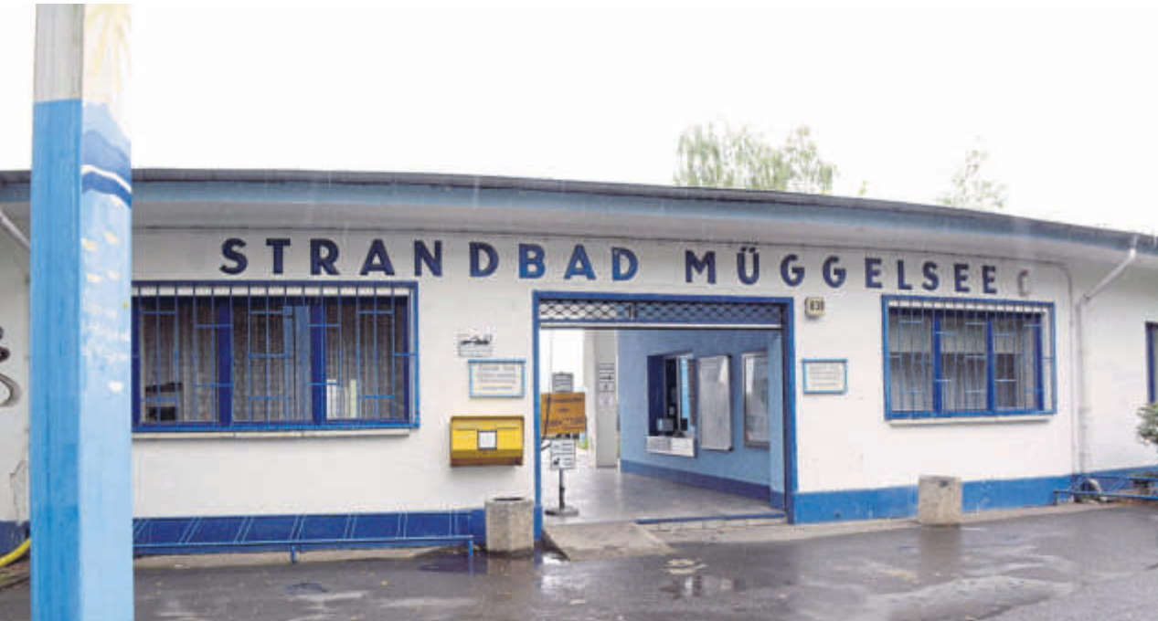
Auch das Eingangsgebäude braucht dringend eine Modernisierung.
